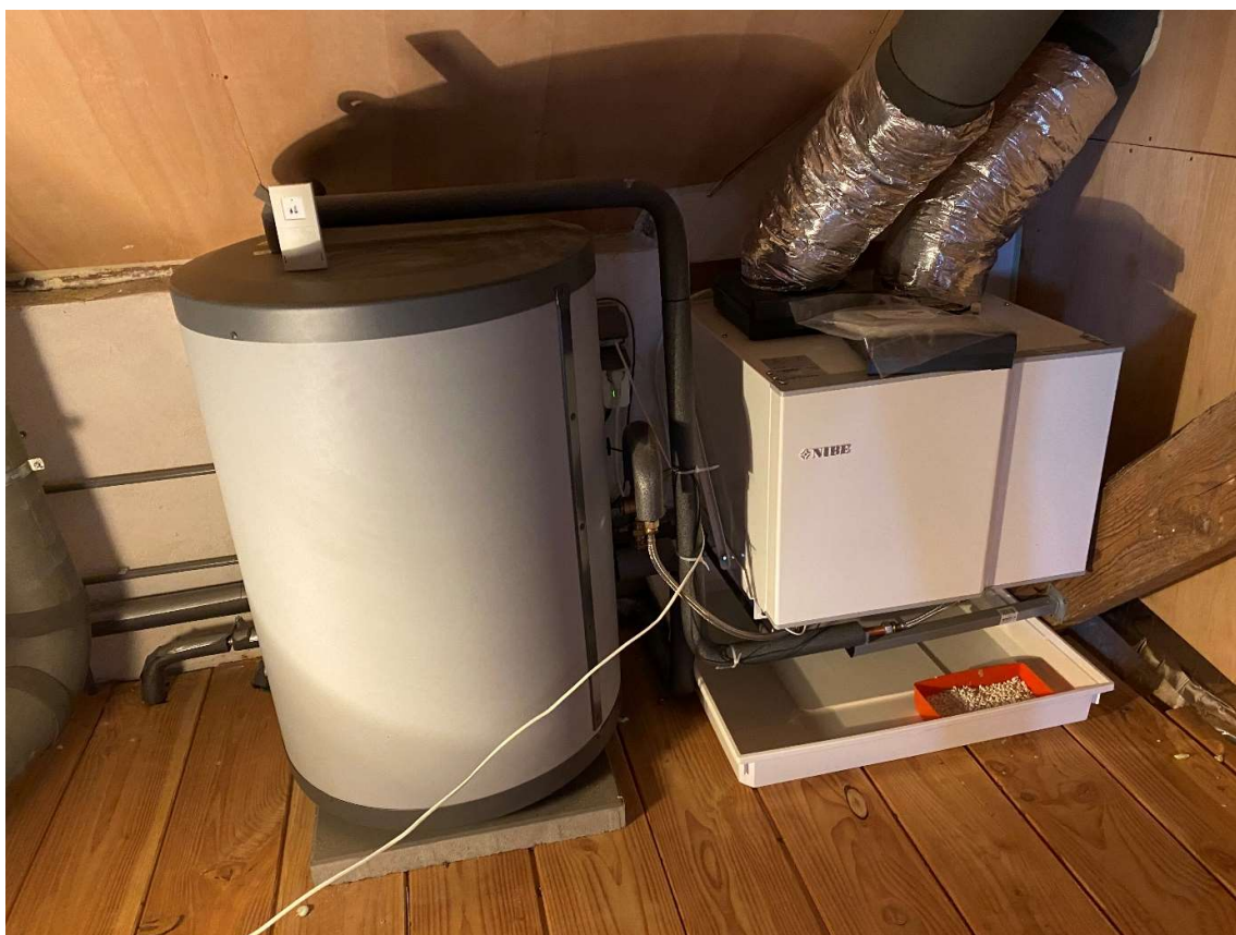
Afb3: Nibe F130 varmtepompboiler en opslagvat 130 l
