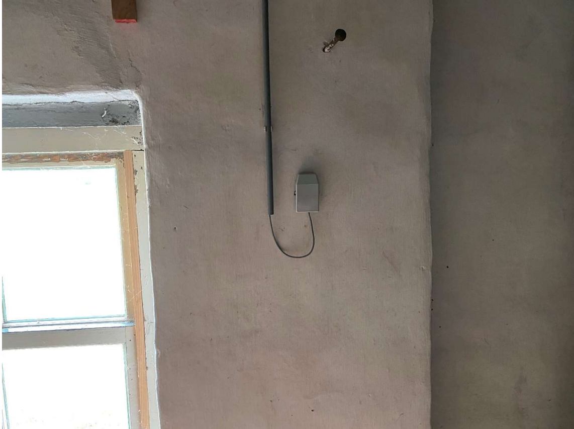
Afb 4 de plaats van de thermostaatvoeler, boven op zolder
