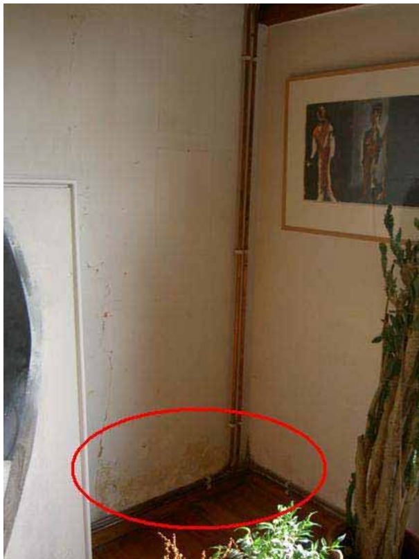
Schimmelvorming onderaan muur
