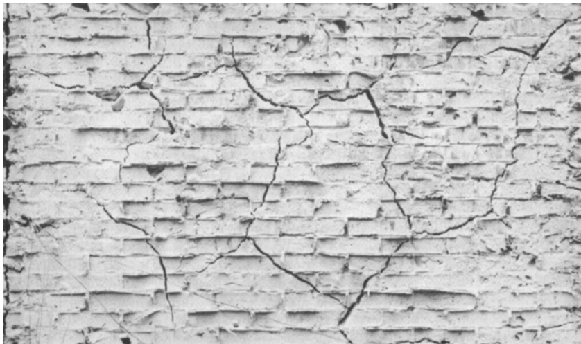
Krimpscheuren in UF-schuim zichtbaar na verwijdering buitenspouwblad [17]
