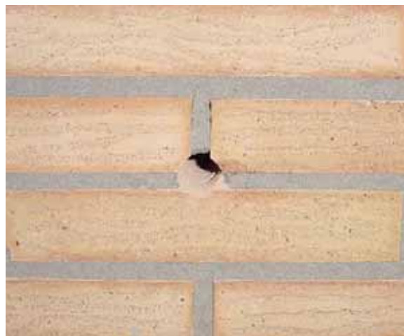
Licht beschadigde bakstenen [37]
